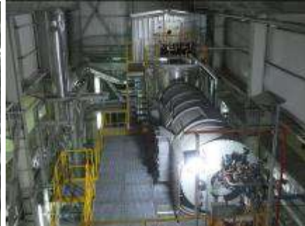
naverbrandingskamer en rookgas koeling
